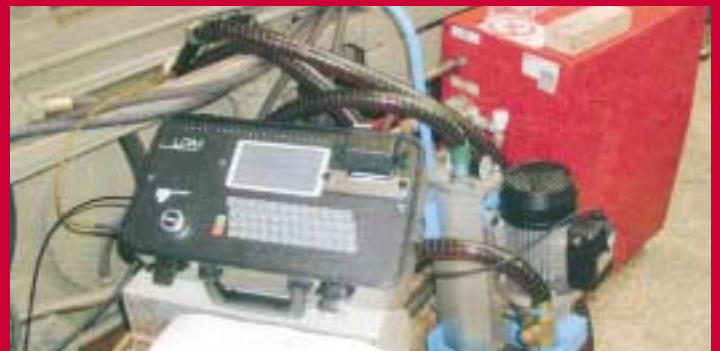
Contatore di particelle e unità di filtrazione "off-line" che lavorano congiuntamente per pulire e monitorare il sistema
